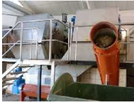
Il·lustració 4: Compactador de sòlids que han sigut tamisats - Font pròpia
